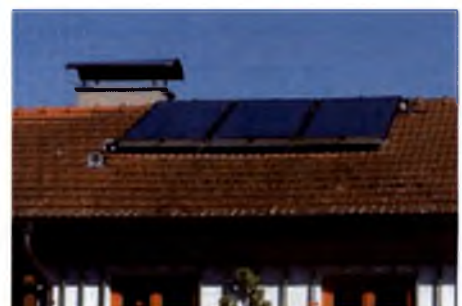
Sonnenkollektoren auf geneigtem Dach
